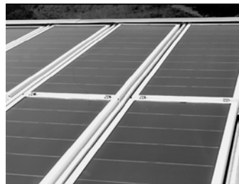
Abb.: Dachfläche mit integrierten Fotovoltaikmodulen.
